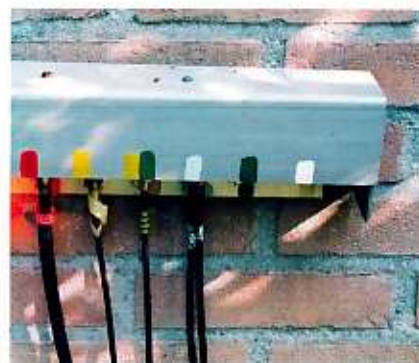
'Het schakelbord', buiten aan de gevel, maakt het mogelijk om bij naderend onweer de antennekabels los te maken. Doe dit niet als het onweer vlak bij is!
